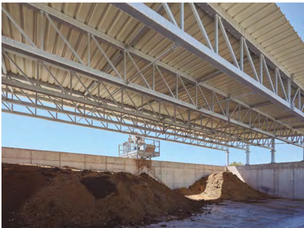
La fracción sólida del digestato se envía al estercolero del IRTA Mas Bové, desde donde se transforma en compost. Fuente: IRTA.
