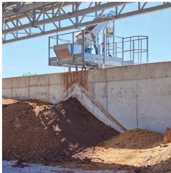
Separador y estercolero de la planta de biogás del IRTA Mas Bové. Fuente: IRTA.
