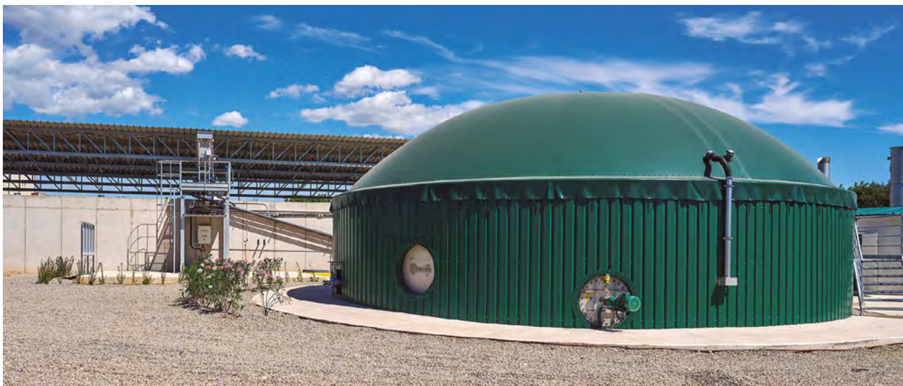
Digestor anaerobio, separador y estercolero de la planta de biogás del IRTA Mas Bové. Fuente: IRTA.
