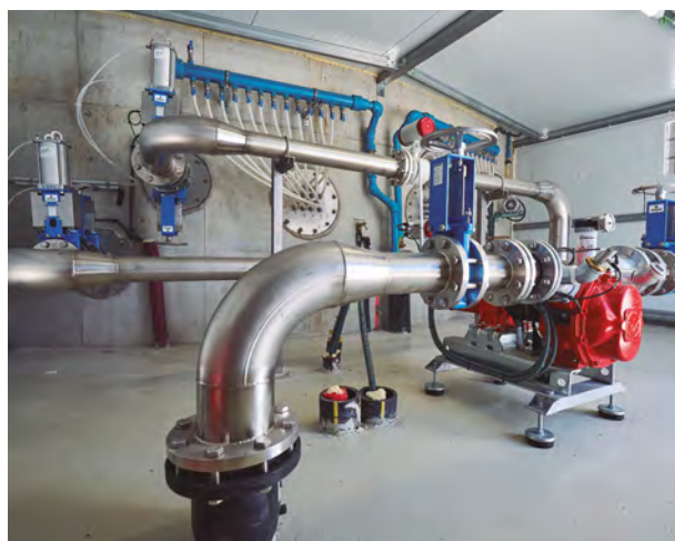
Sala de bombeo del digestor anaerobio del IRTA Mas Bové. Fuente: IRTA.
