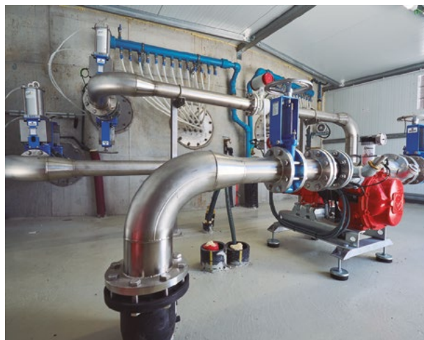
Sala de bombeig del digestor anaerobi de l'IRTA Mas Bové. Font: IRTA.
